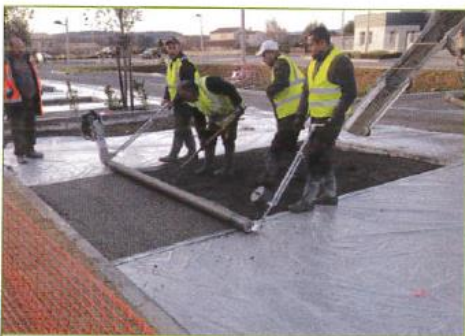
La Tour d'Aigues : le béton (ciment CEM II/ 42,5 A Calcia Beaucaire, additif Grace Pieri, granulats 2/6) a été égalisé avec un rouleau mécanique non vibrant (Striker).
