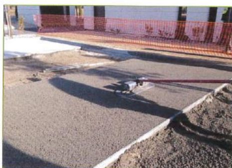
La Tour d'Aigues : pour une finition précise et esthétique du béton drainant, l'équipe de Provence Impressions a utilisé une lisseuse vibrante de type Mag Vibe.
